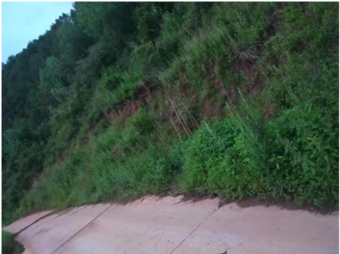
图二：滑坡隐患点照片
