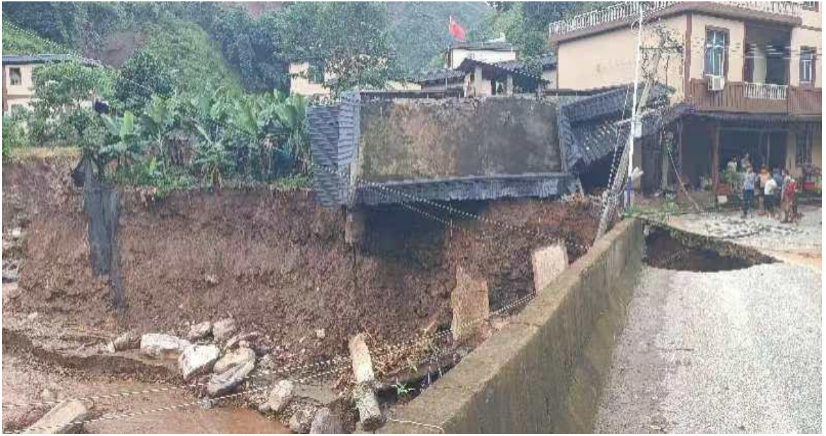
图5 灾后房屋冲毁倒塌
