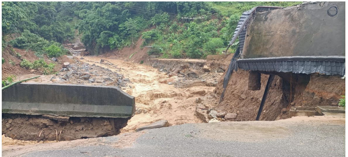
图6 灾后房屋、桥梁冲毁
